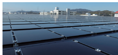
拾石工場第7棟 太陽光パネル
