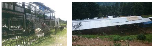
(左): 骨組みのみを残し、崩壊した学校の校舎 (右): 崩壊した学校横に建てられた仮設の校舎 小学生500名、中学生150名、高校生150名の合計約800名の生徒が、屋根のみの仮設校舎で勉強を続けています。
