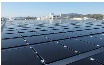
拾石工場第7棟の屋根には、太陽光パネルが設置されています。
