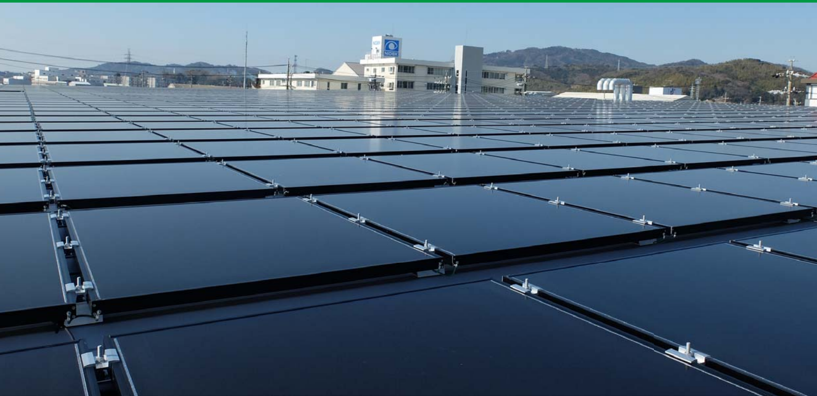
▲ 拾石工場第7棟に設置した太陽光パネル。この他にも浜町工場、大沢工場にも太陽光発電システムを導入しています。
