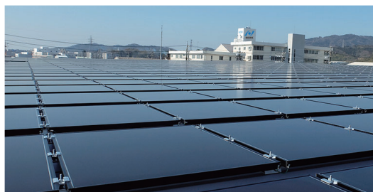
拾石工場第7棟 太陽光パネル
