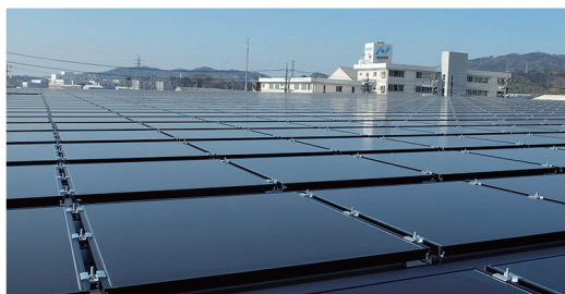
拾石工場第7棟 太陽光パネル
